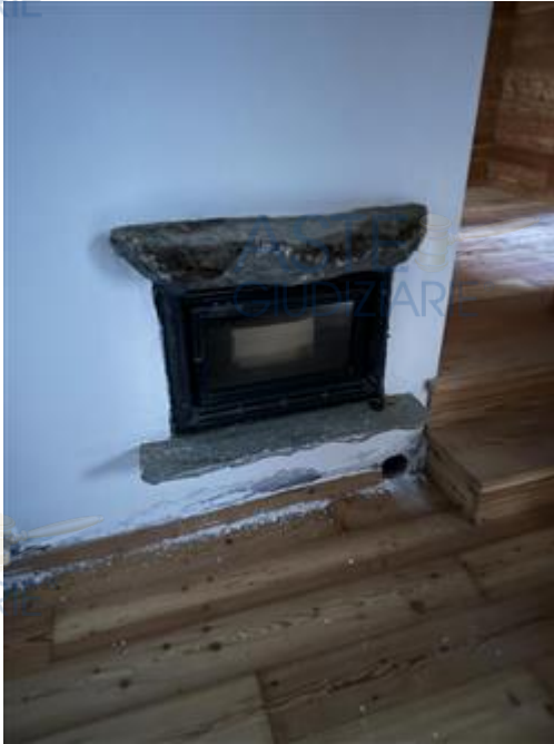
Particolare camino nel soggiorno
