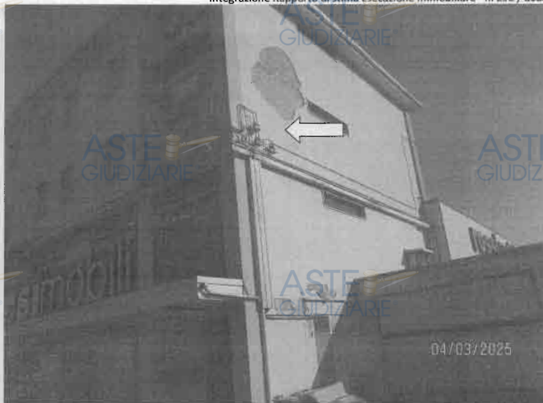
FOTO 1 – Tre dei cinque contatori individuali del gas, a valle del contatore principale, sono collocati a oltre 6 metri di altezza da terra, accessibili solo con elevatore.
