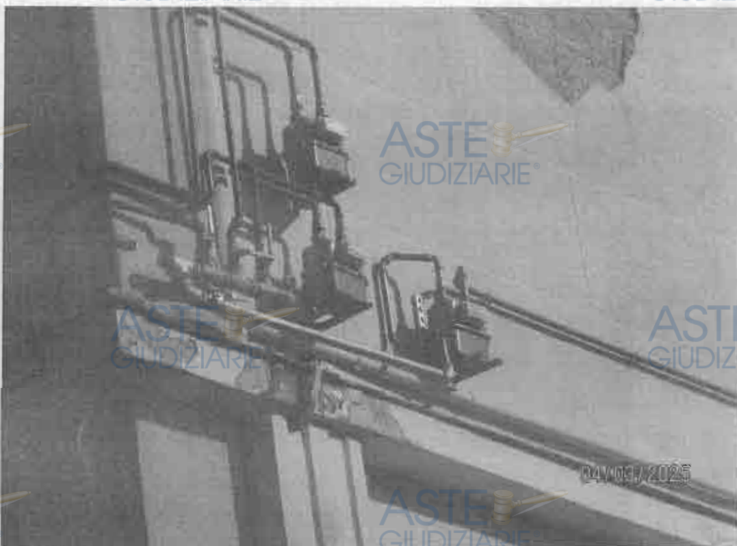
FOTO 2 – Dettaglio dei tre contatori gas della foto precedente. Altri due sono collocati in prossimità delle caldaie individuali di riferimento. Un solo alloggio e' ancora collegato all'impianto centralizzato originario, non funzionante, e pertanto privo di riscaldamento.
