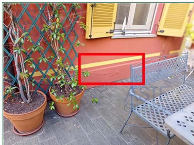
Fenomeni di umidità di risalita in esterno
