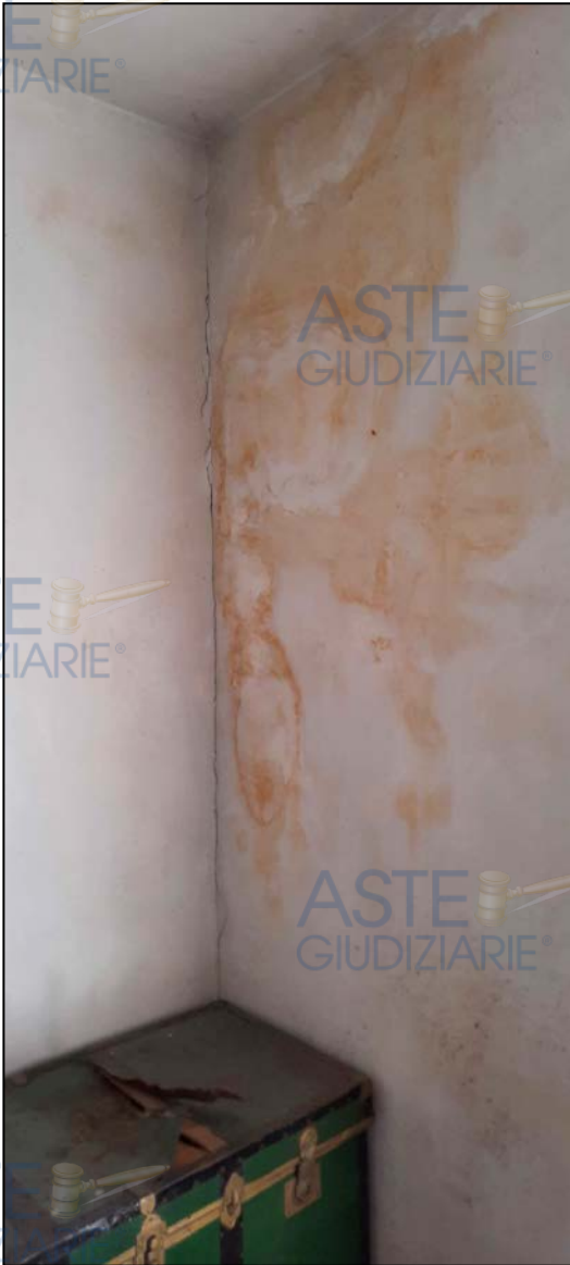
Infiltrazioni piovane su pareti esterne
