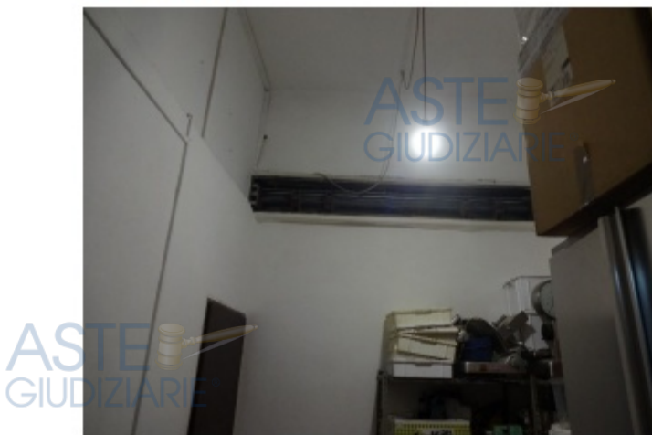
Foto 15 - Deposito n.1 (Serramento di accesso ostruito da muratura)
