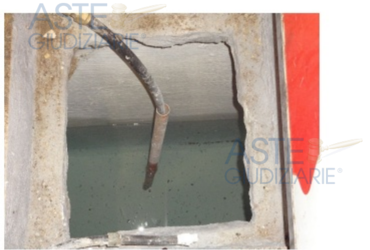
Foto 12 - Vasca idrica interrata
