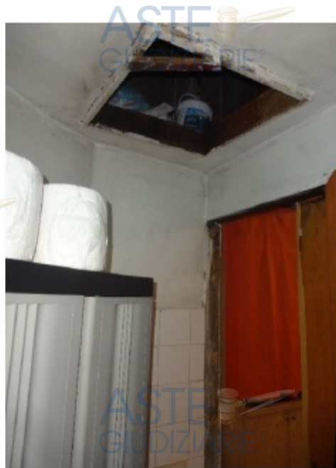
Foto 18 - WC n.1 (nella foto è raffigurata la botola di accesso al controsoffitto)
