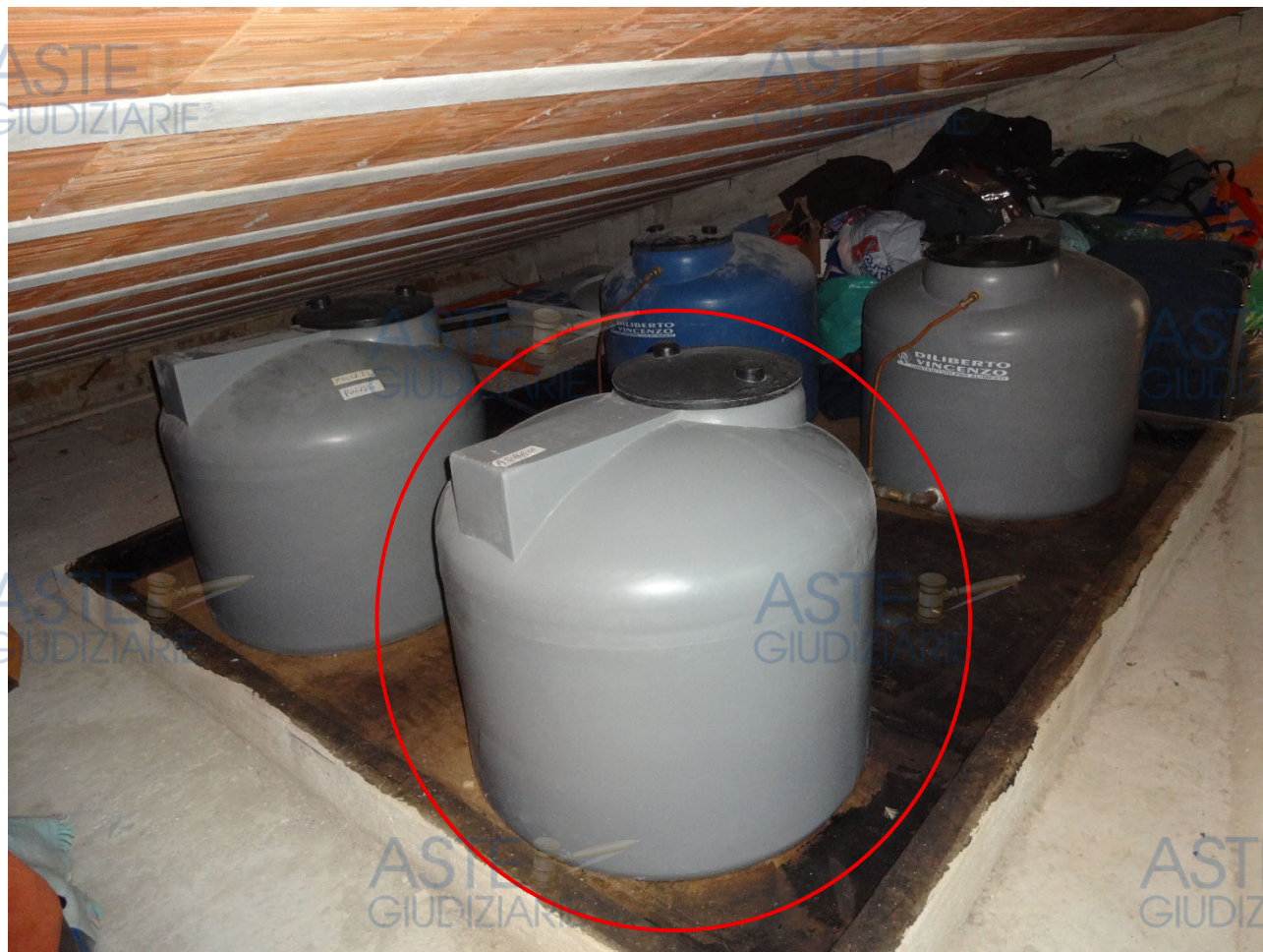
Foto 7-Vasche idriche ubicate nel sottotetto condominiale (quella cerchiata in rosso è a servizio dell'appartamento costituente il lotto)
