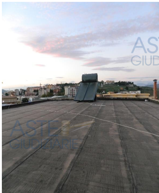
Particolare Copertura di pertinenza con solare Termico
