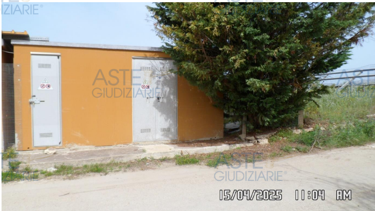
Figura 3 – Vista della cabina elettrica.
