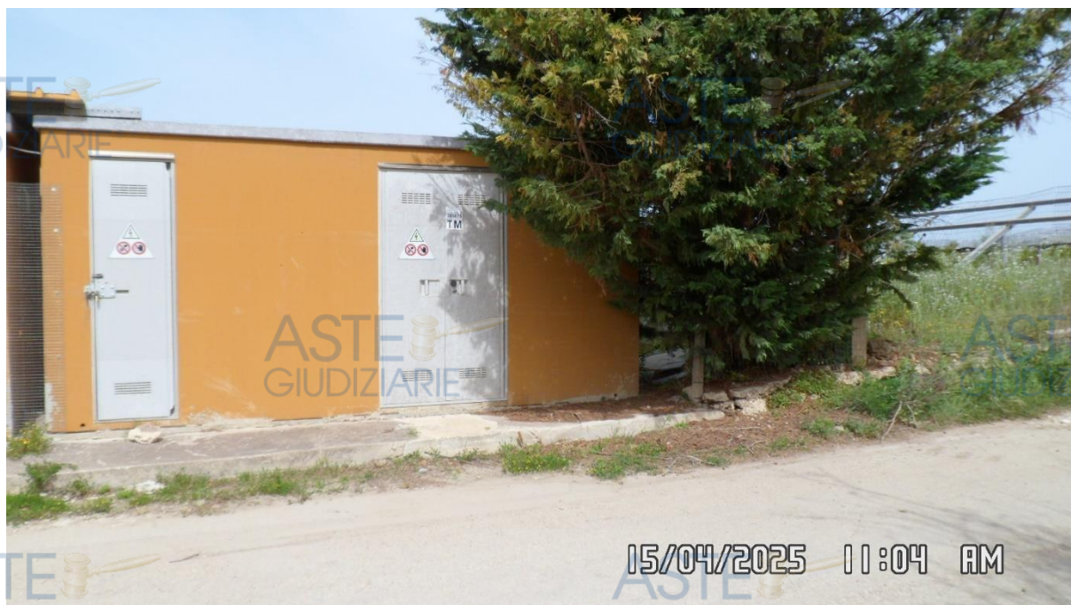
Foto 4 – Veduta della cabina elettrica
