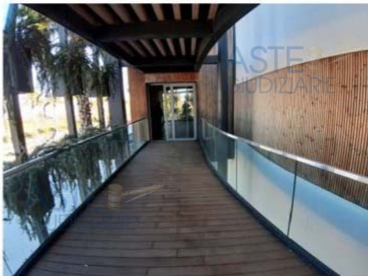
Foto n. 321 – Fabbricato "Club House" - Fg. 53 part. 443-444 sub 1 - piano primo
