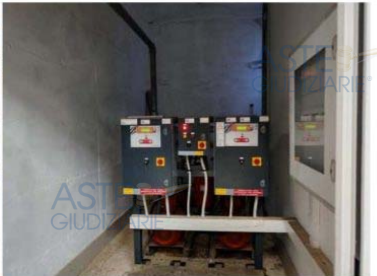
Foto n. 220 – Fg. 53 part. 1 sub 4 – piscina – locale impianti
