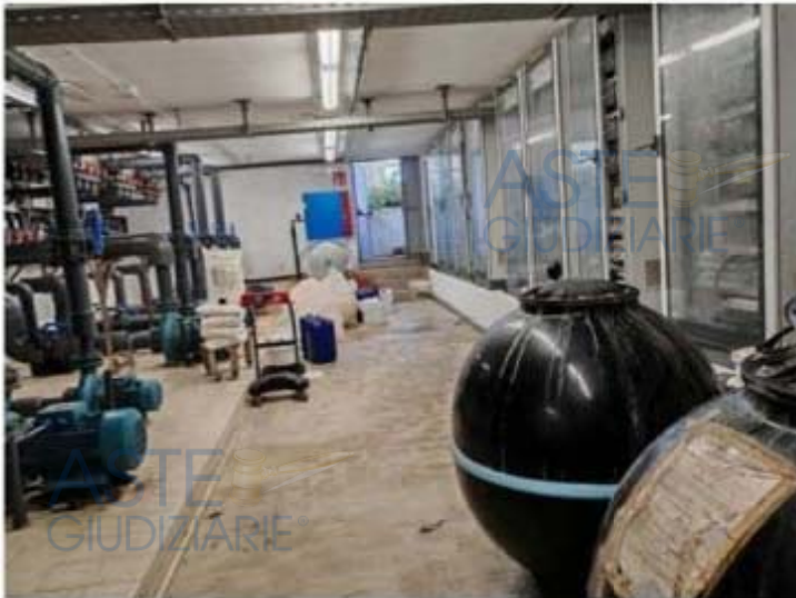
Foto n. 229 – Fg. 53 part. 1 sub 4 – fontana danzante – locale impianti
