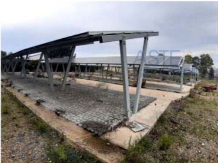
Foto n. 373 – Fg. 54 part. 881 sub 1 – impianto fotovoltaico
