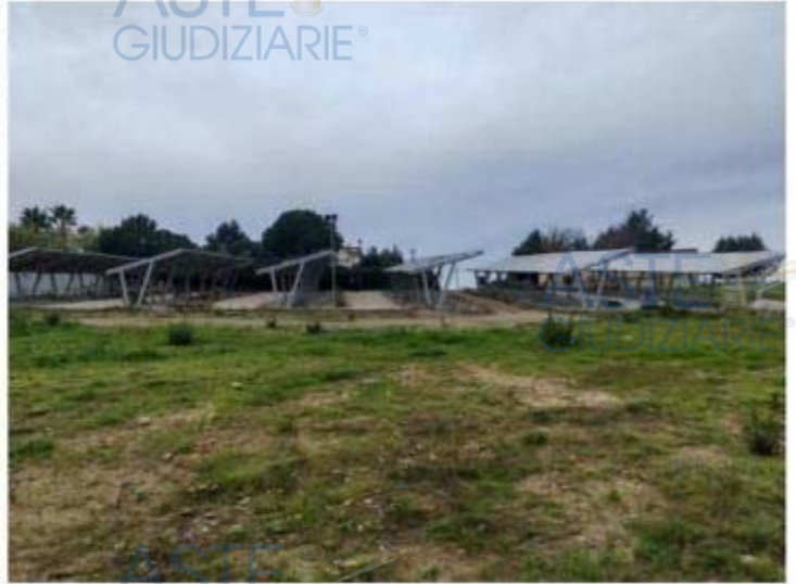
Foto n. 372 – Fg. 54 part. 881 sub 1 – impianto fotovoltaico
