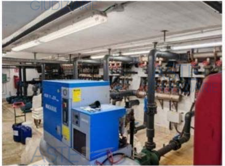
Foto n. 228 – Fg. 53 part. 1 sub 4 – fontana danzante – locale impianti
