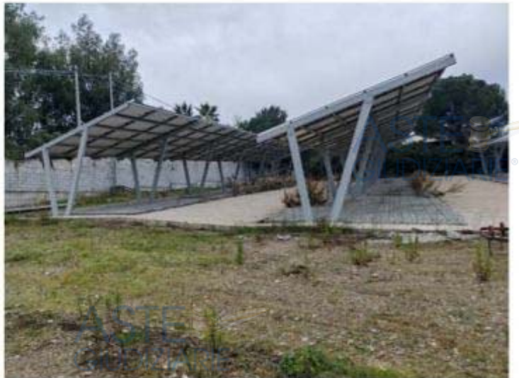
Foto n. 374 – Fg. 54 part. 881 sub 1 – impianto fotovoltaico
