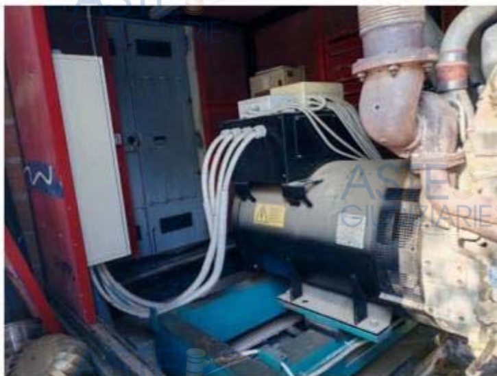
Foto n. 378 – Cabina ENEL e Locali impianti
