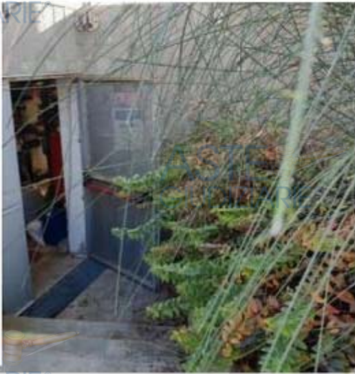
Foto n. 227 – Fg. 53 part. 1 sub 4 – fontana danzante – locale impianti
