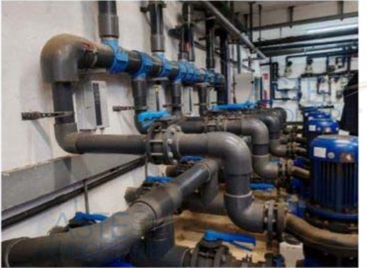
Foto n. 218 – Fg. 53 part. 1 sub 4 – piscina – locale impianti
