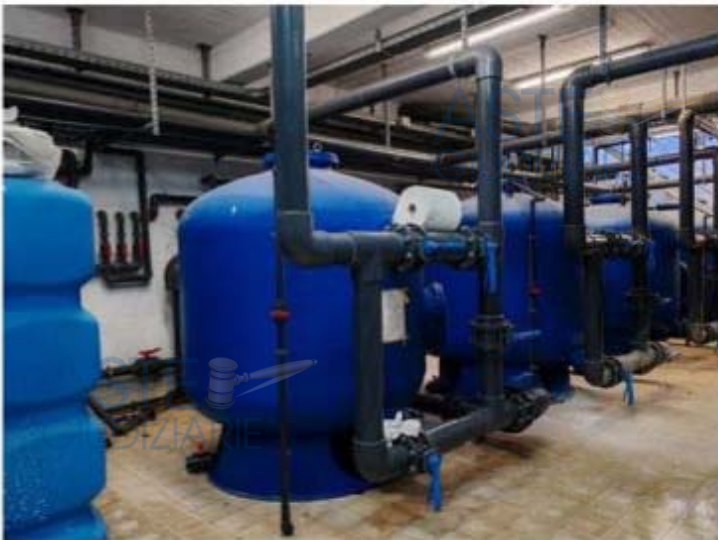
Foto n. 219 – Fg. 53 part. 1 sub 4 – piscina – locale impianti
