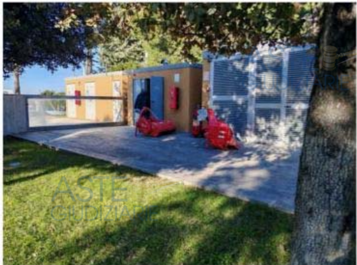
Foto n. 376 – Cabina ENEL e Locali impianti
