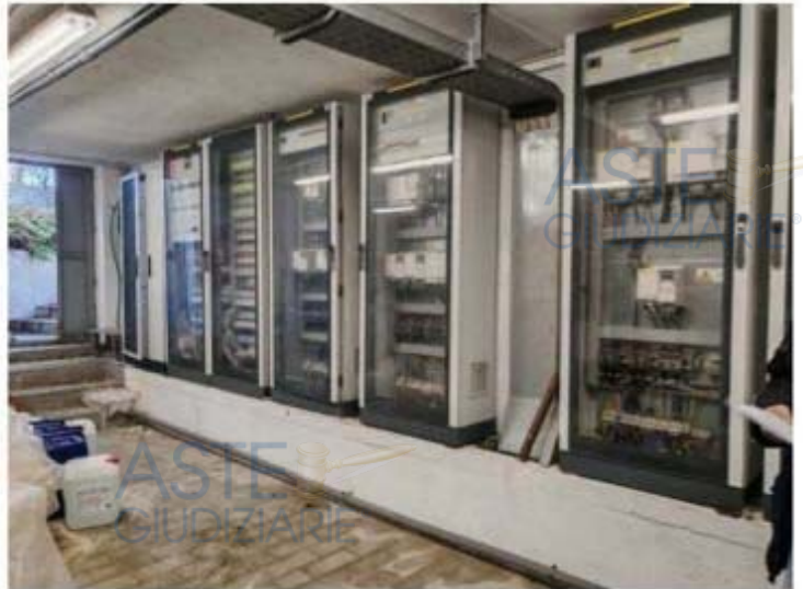
Foto n. 230 – Fg. 53 part. 1 sub 4 – fontana danzante – locale impianti
