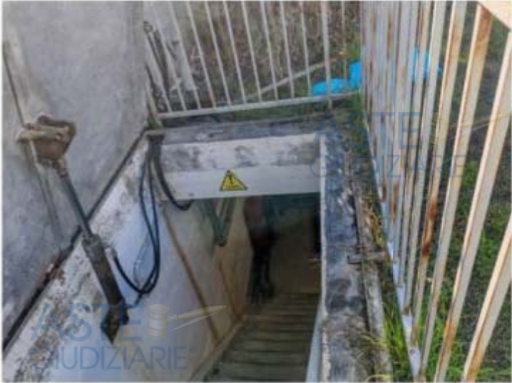
Foto n. 217 – Fg. 53 part. 1 sub 4 – piscina – locale impianti
