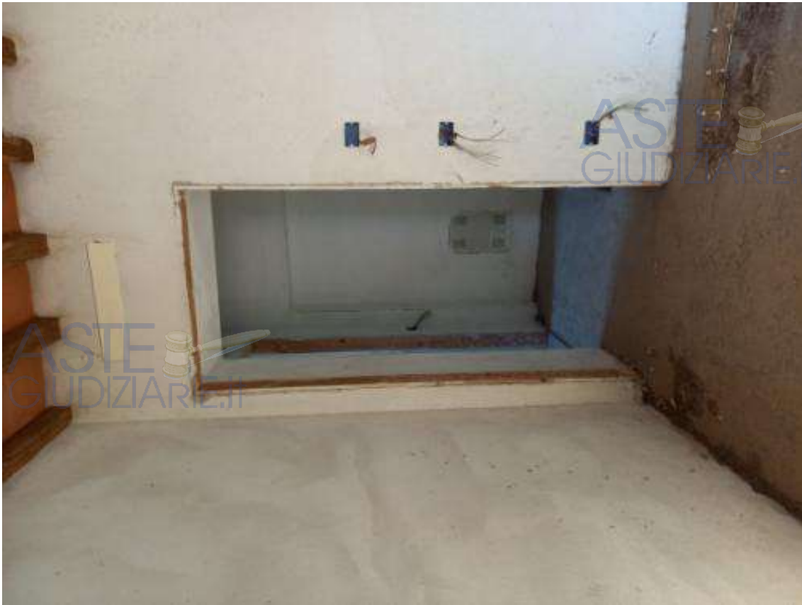
Foto 11 – collegamenti interni locali piano terra
