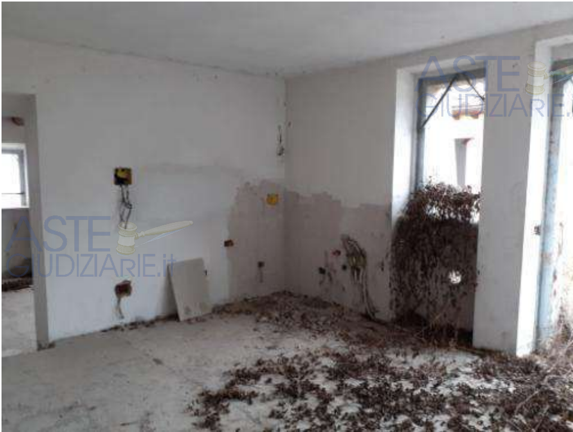
Foto 3 – locale con attacchi cucina piano seminterrato
