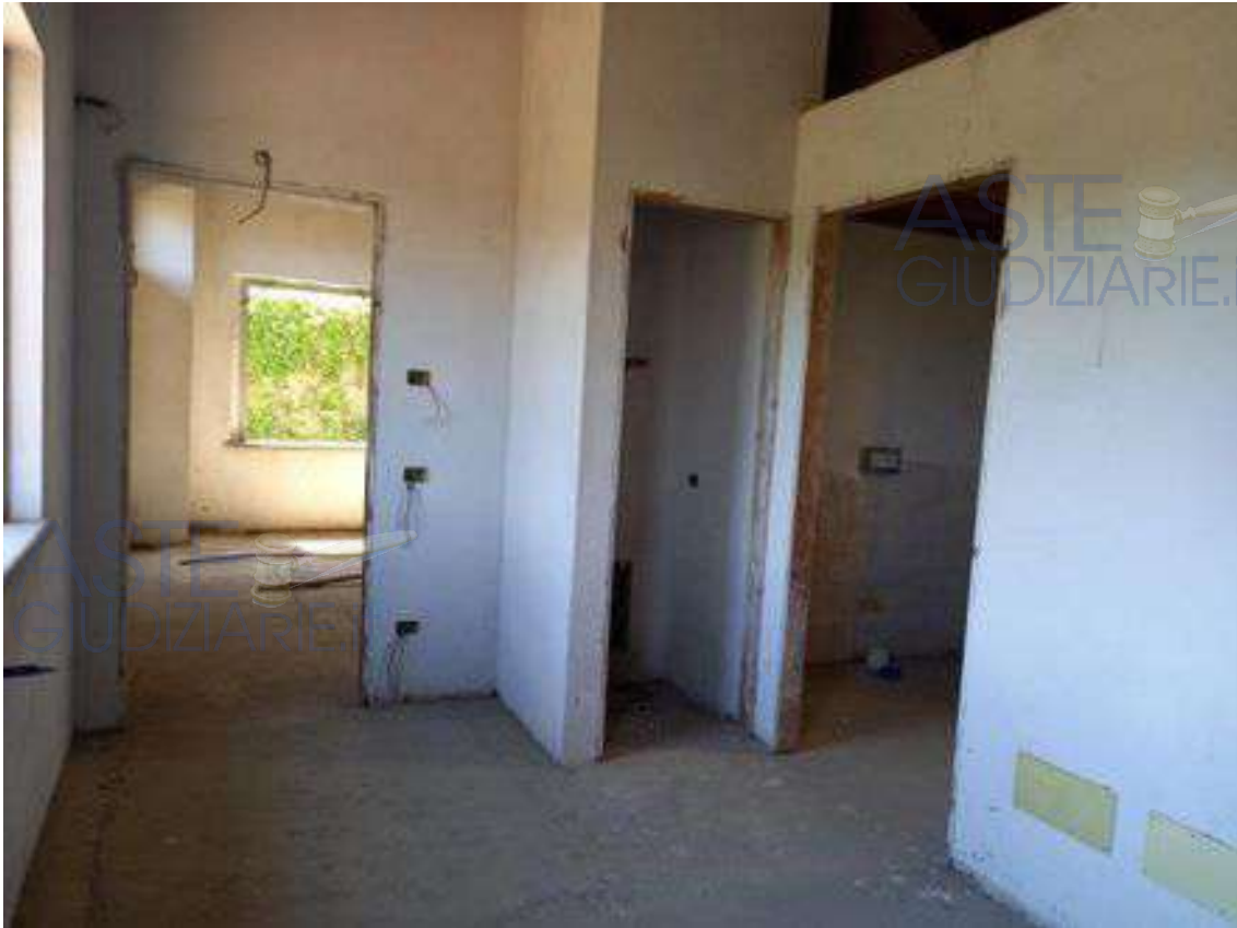
Foto 9 – locali piano primo con individuazione posizionamento impianti
