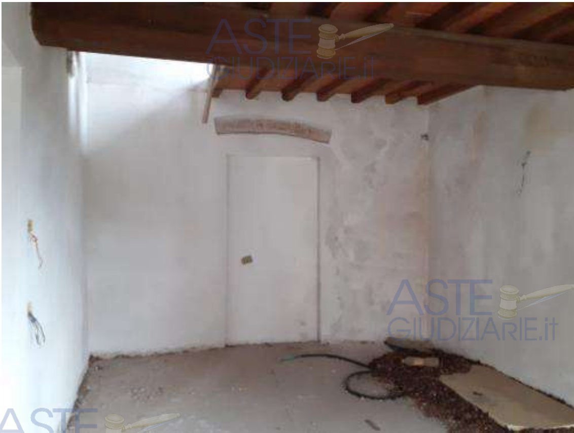
Foto 2 – individuazione collegamento verticale solaio interpiano
