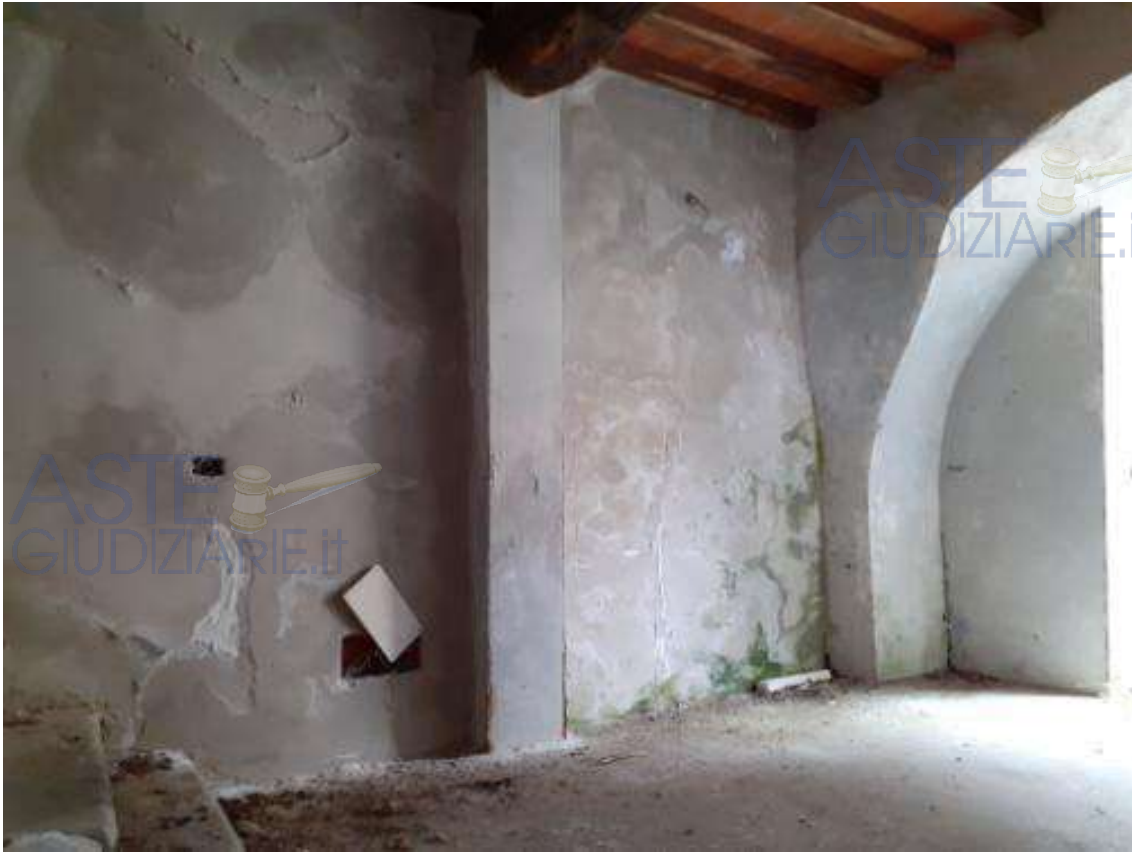
Foto 5 – parete piano seminterrato contro terra interessata dall'umido
