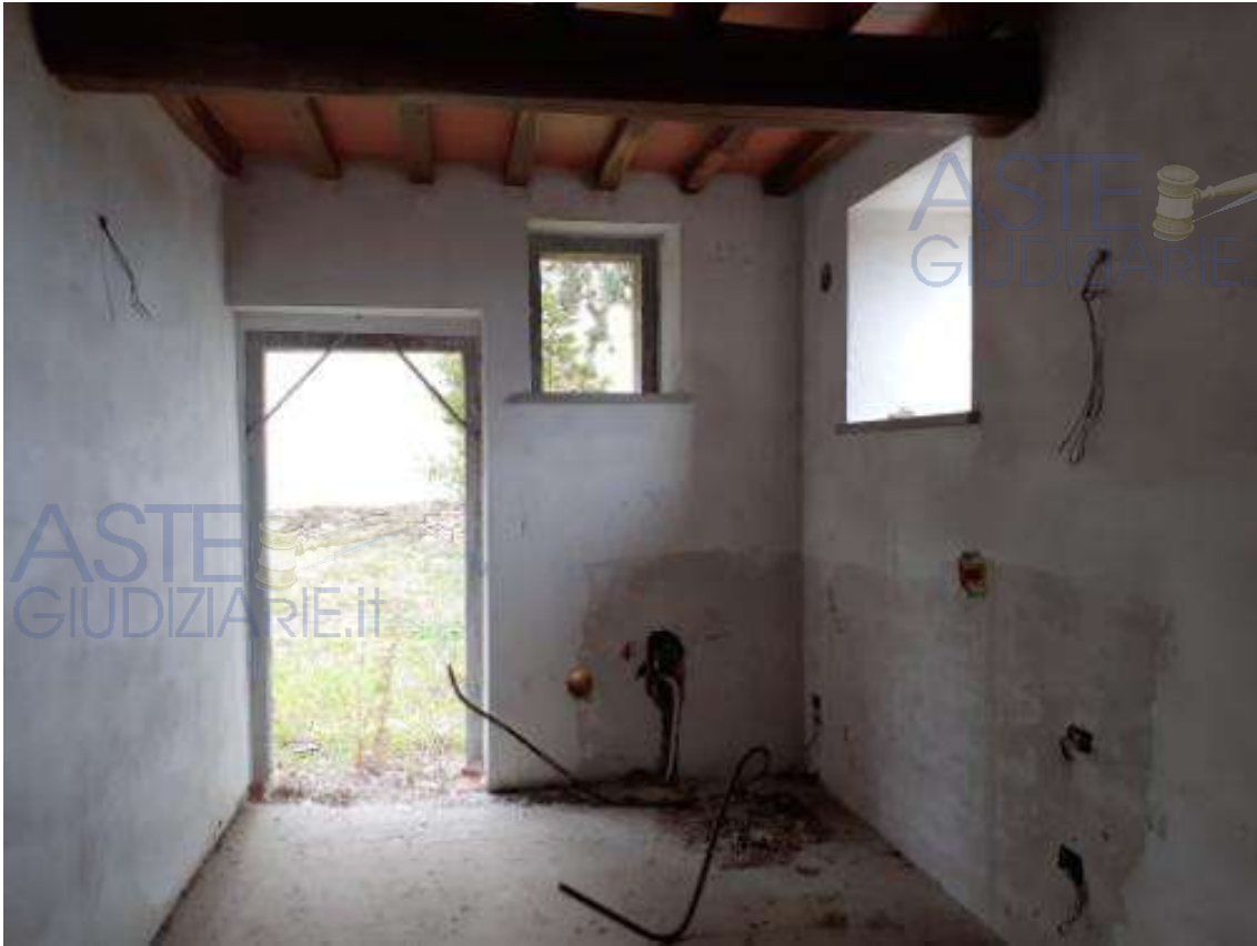
Foto 1 – attacchi cucina piano seminterrato
