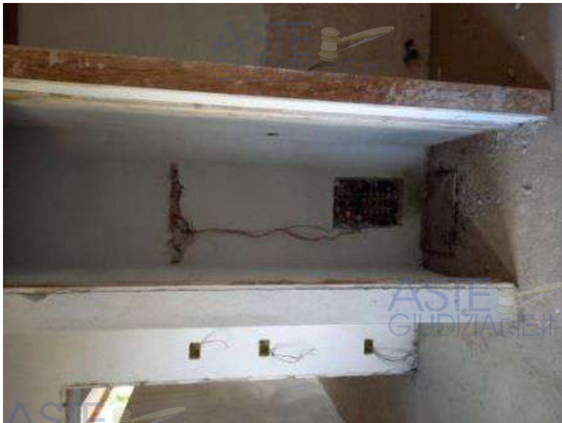
Foto 10 – vano con attacchi caldaia posto al piano primo
