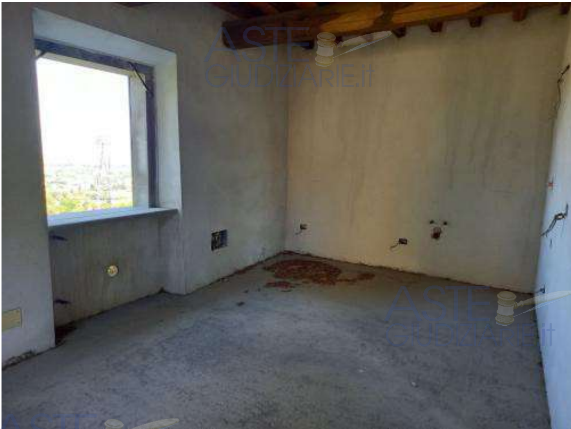
Foto 10 – attacchi cucina locale piano terra
