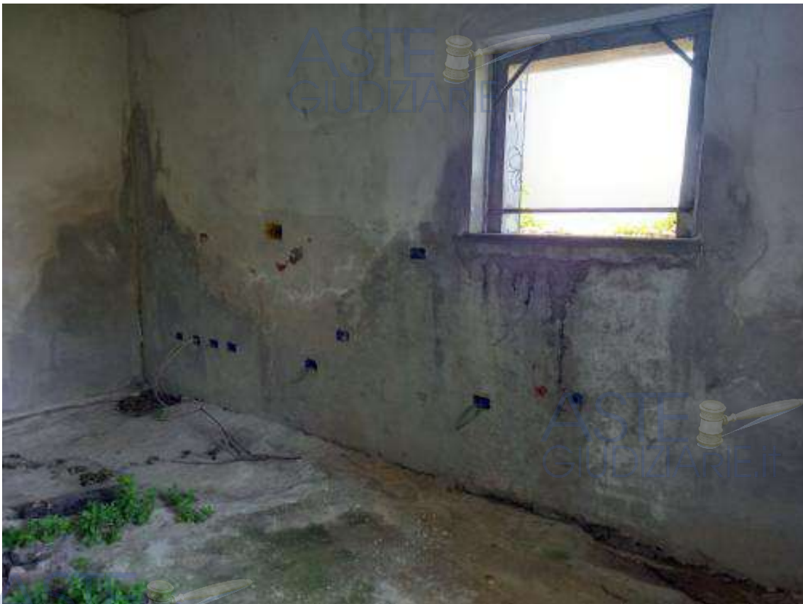
Foto 2 – locale con attacchi cucina piano seminterrato
