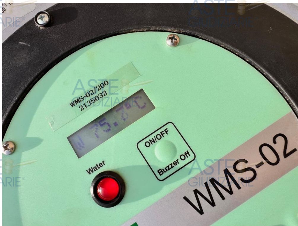
Foto 6 – Prova di Temperatura
