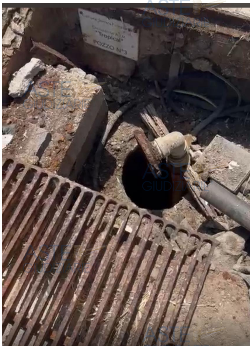
Foto 1 - Pozzo 3 con la tubazione interna
