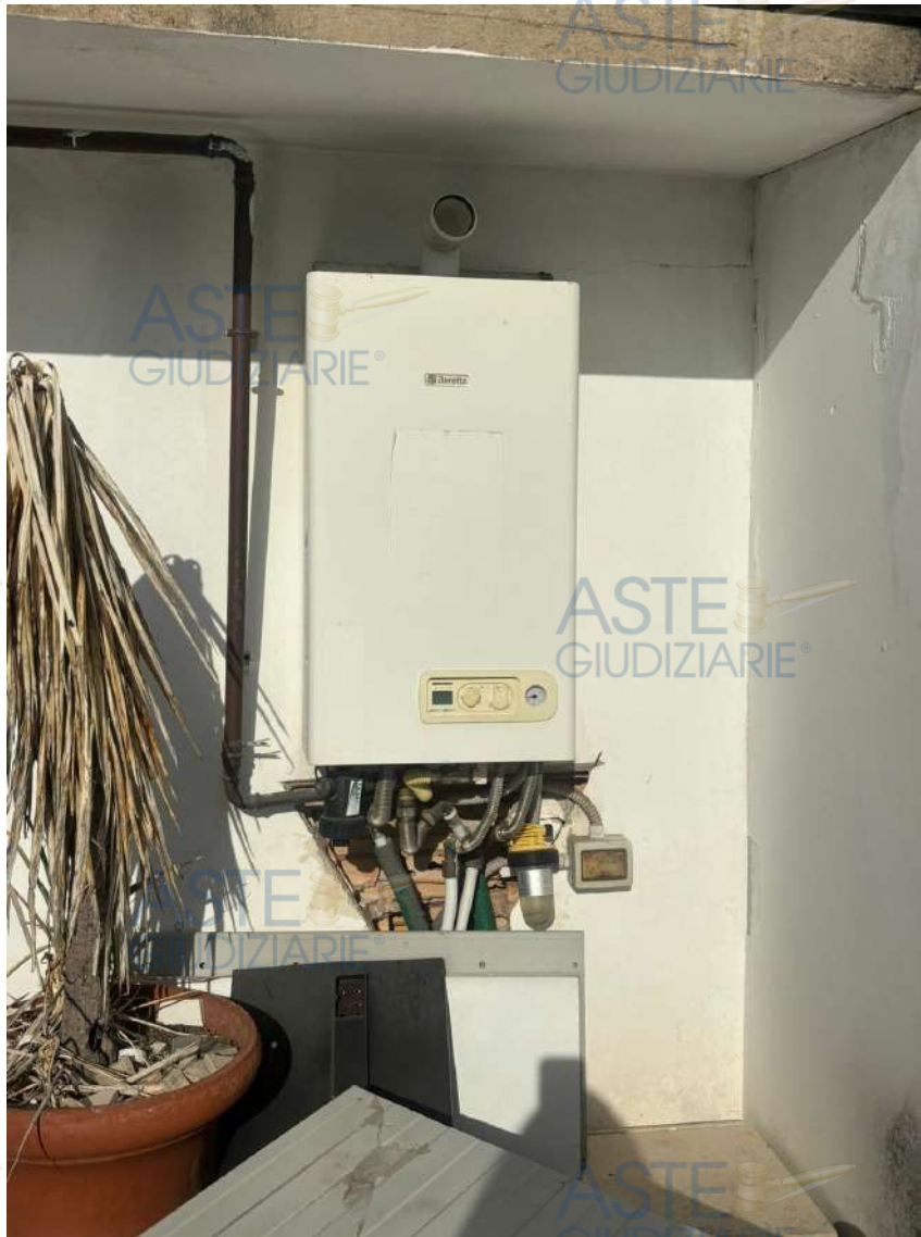
Foto 32 Caldaia Foglio 10 - Part.896 - Sub.19 Piano quarto
