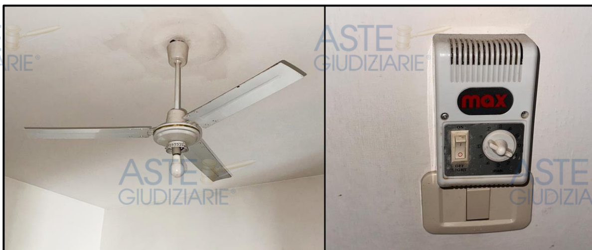
Sistema di ventilazione: ventilatori a soffitto
