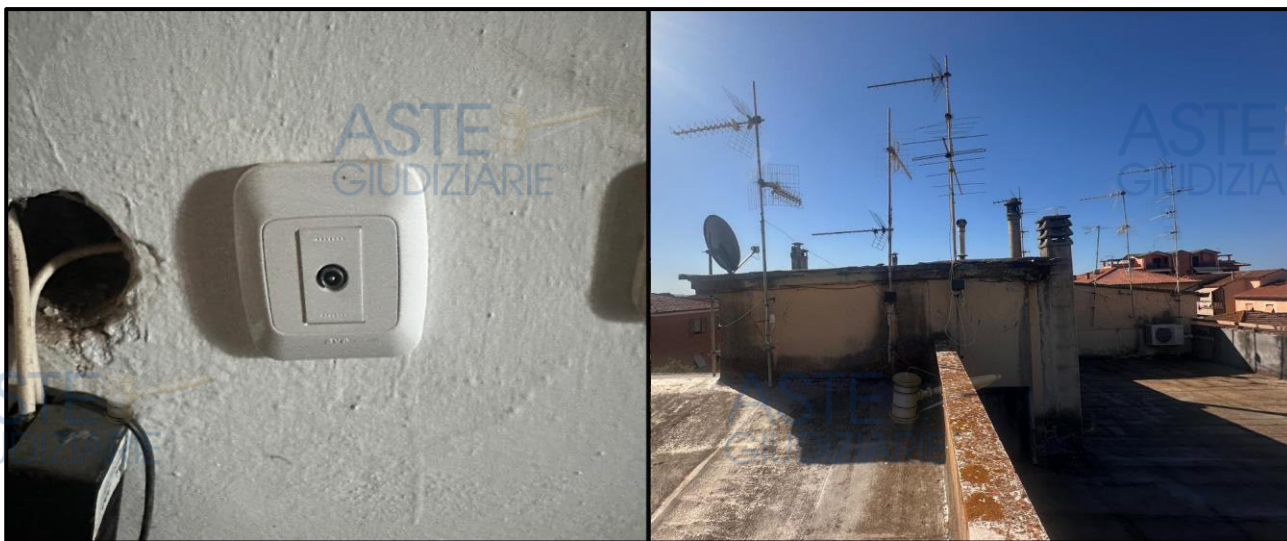
Impianto radiotelevisivo: presa TV, e antenne in copertura
