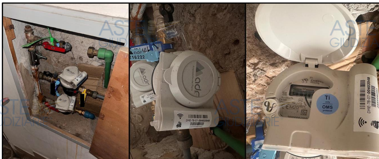
Impianto idrico: contatori nel vano scala
