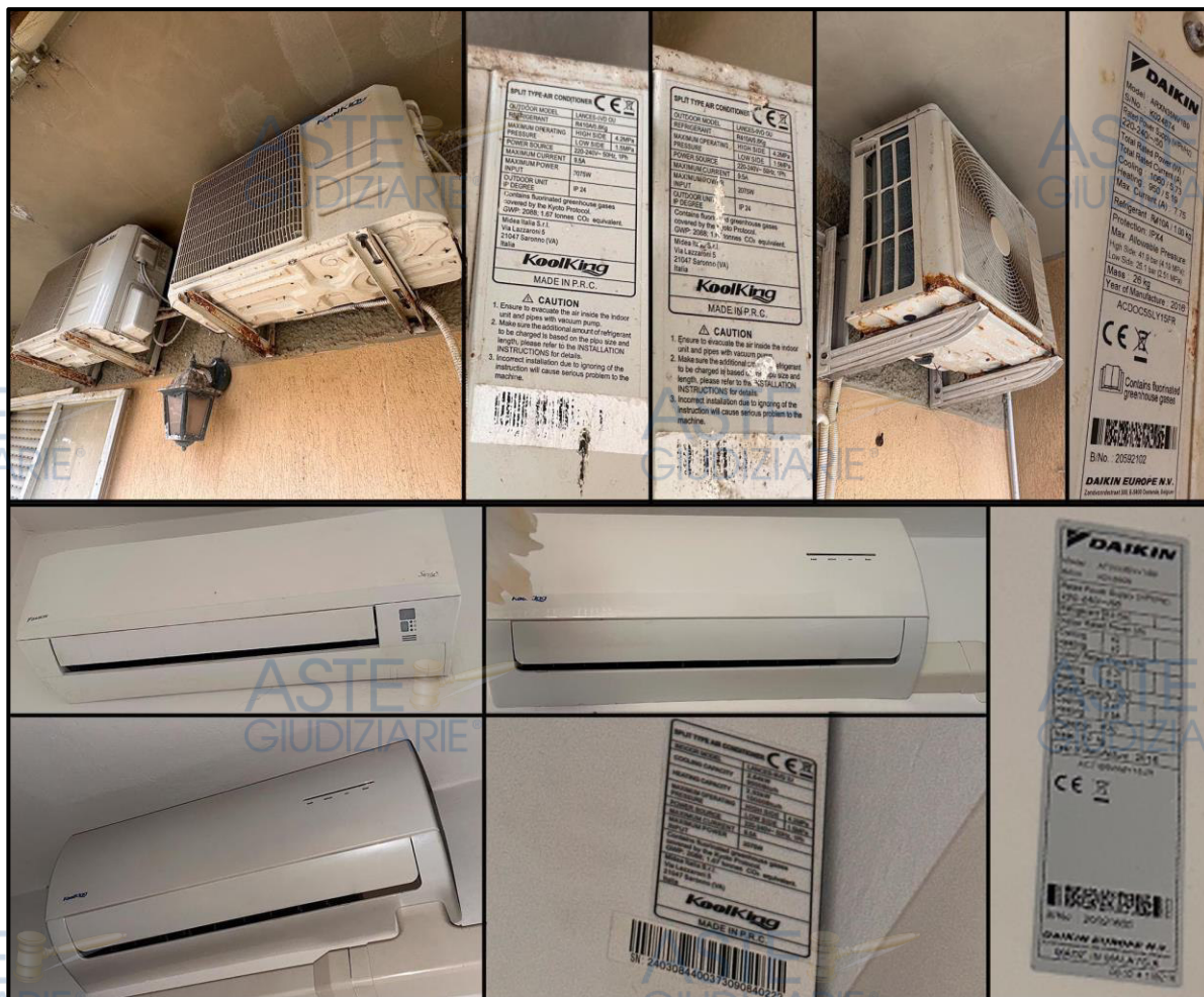
Impianto raffrescamento: 3 x pompe di calore mono e split interni
