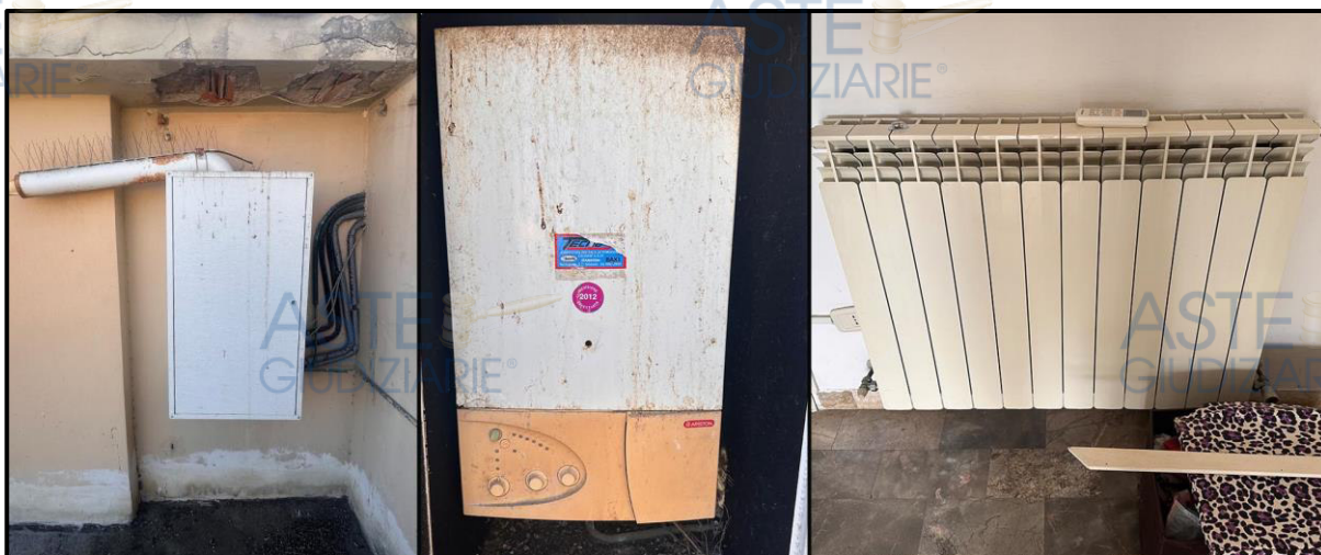
Caldaia murale a gas GPL e radiatore
