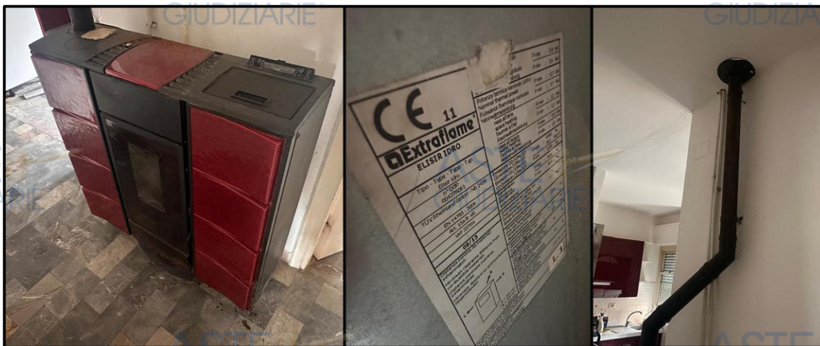
Impianto riscaldamento: stufa a pellet
