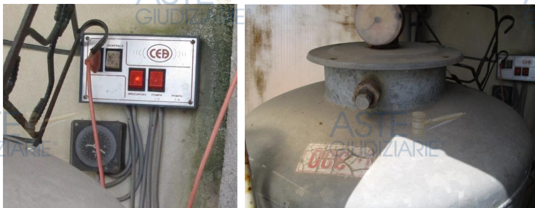
Fig. 11 e 12 – Interruttore bruciatore e pompa; serbatoio gasolio
