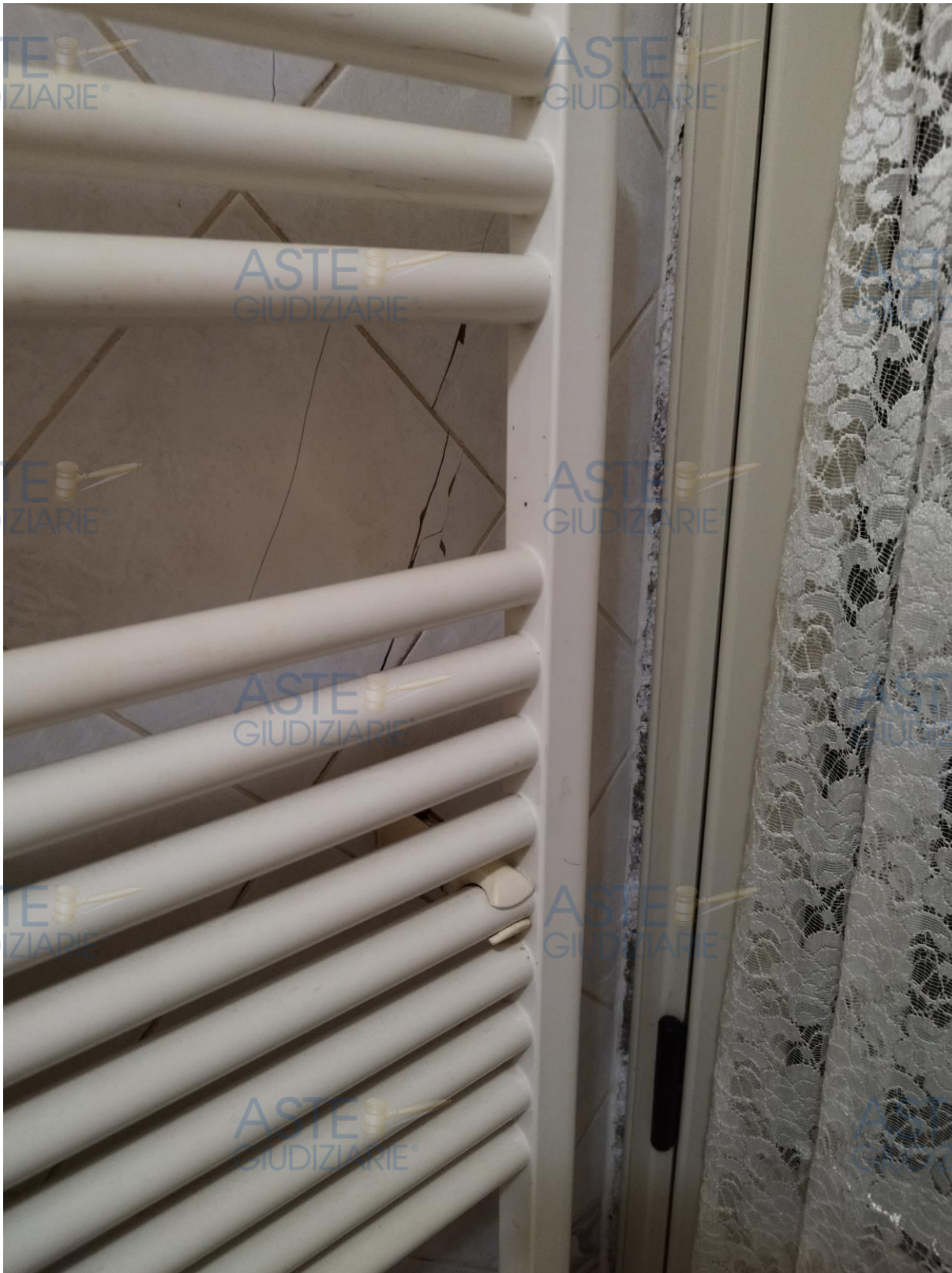
Foto 15: lesioni nei muri vano w.c.
