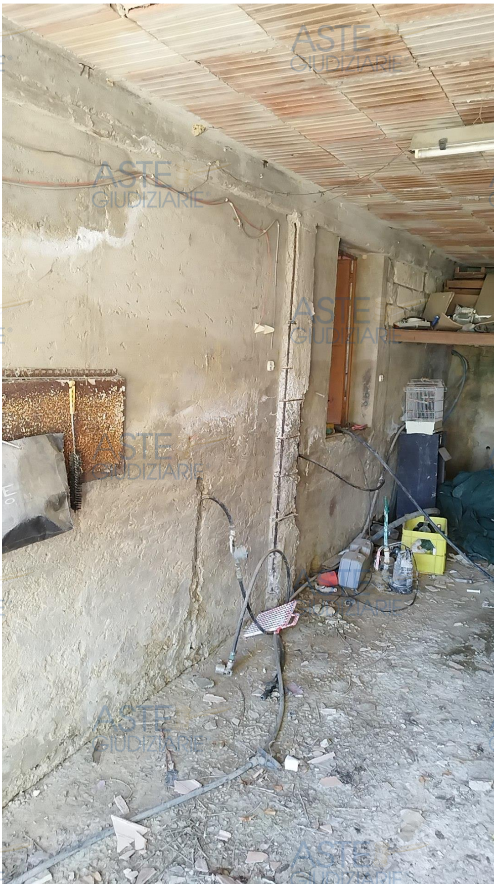
Foto 36: garage/magazzino – distacco cemento copriferro pilastri
