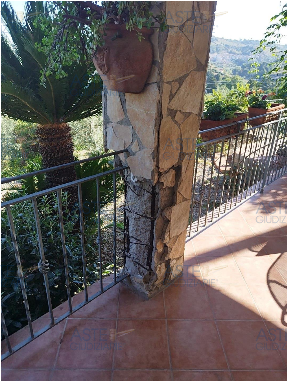
Foto 29: distacco cemento copriferro pilastro portico
