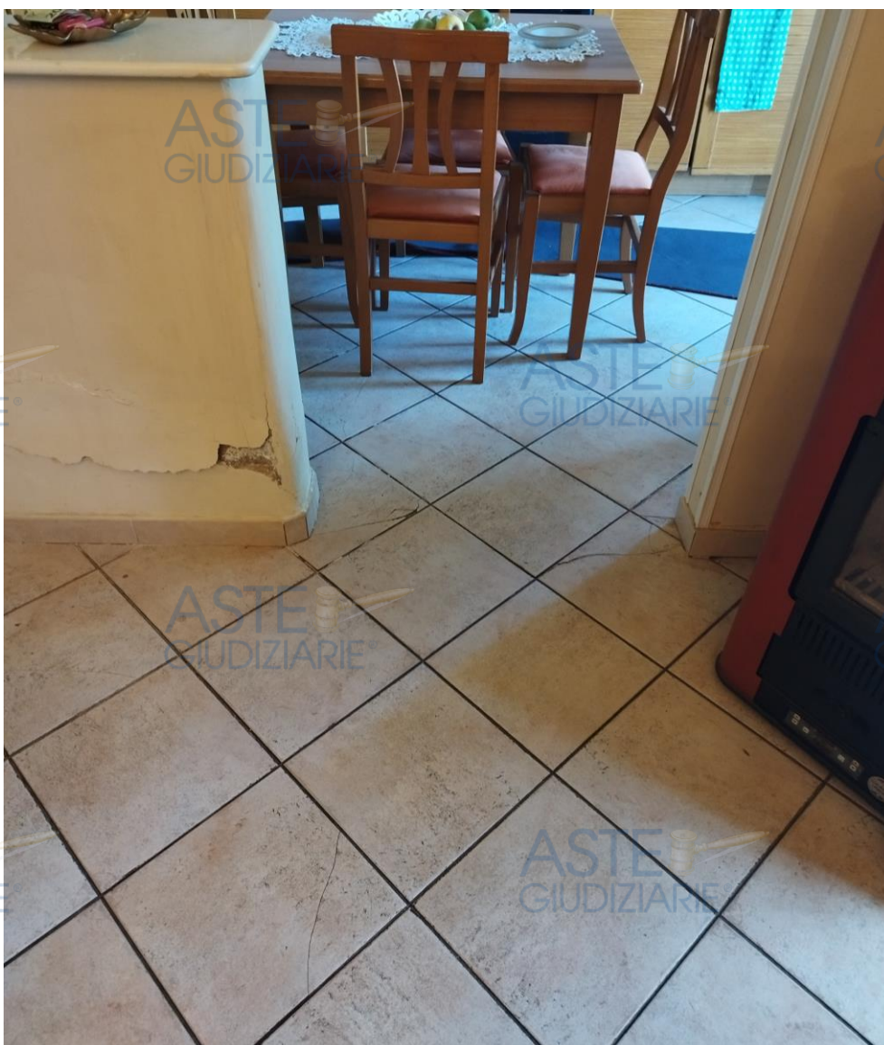
Foto 3 - 4: lesioni nella pavimentazione e umidità nelle pareti
