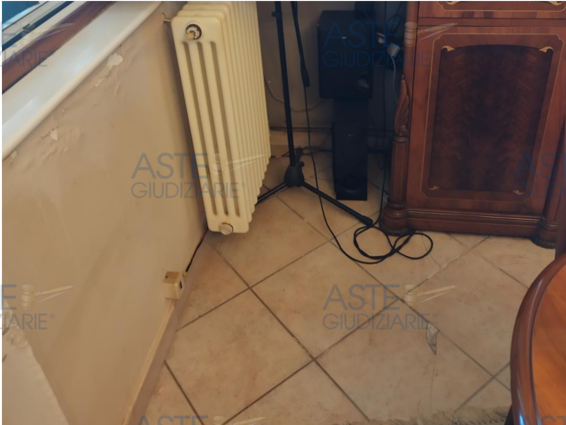
Foto 6: umidità nelle pareti
