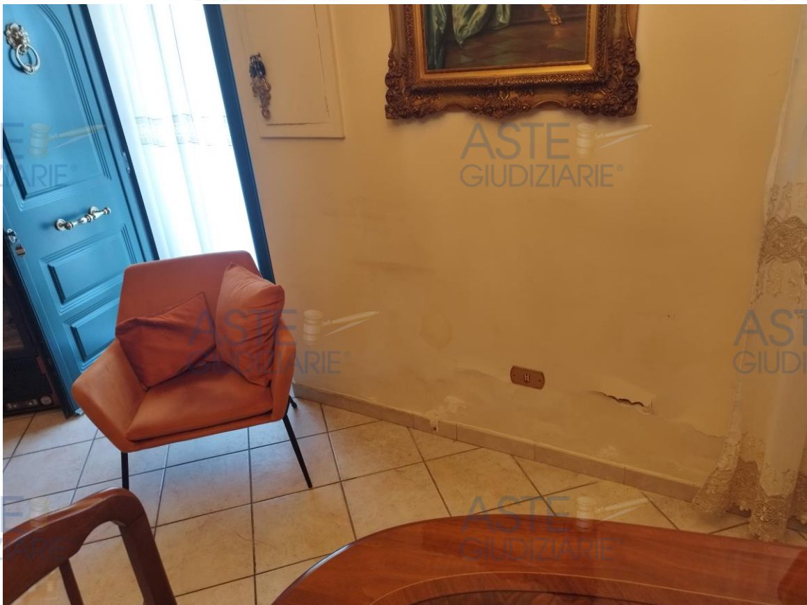
Foto 7: umidità nelle pareti
