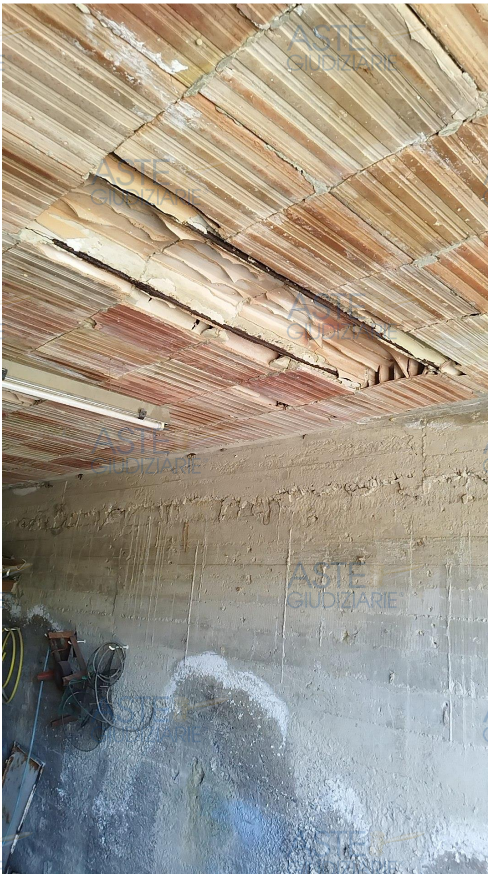
Foto 37: garage/magazzino – sfondellamento solaio di copertura
