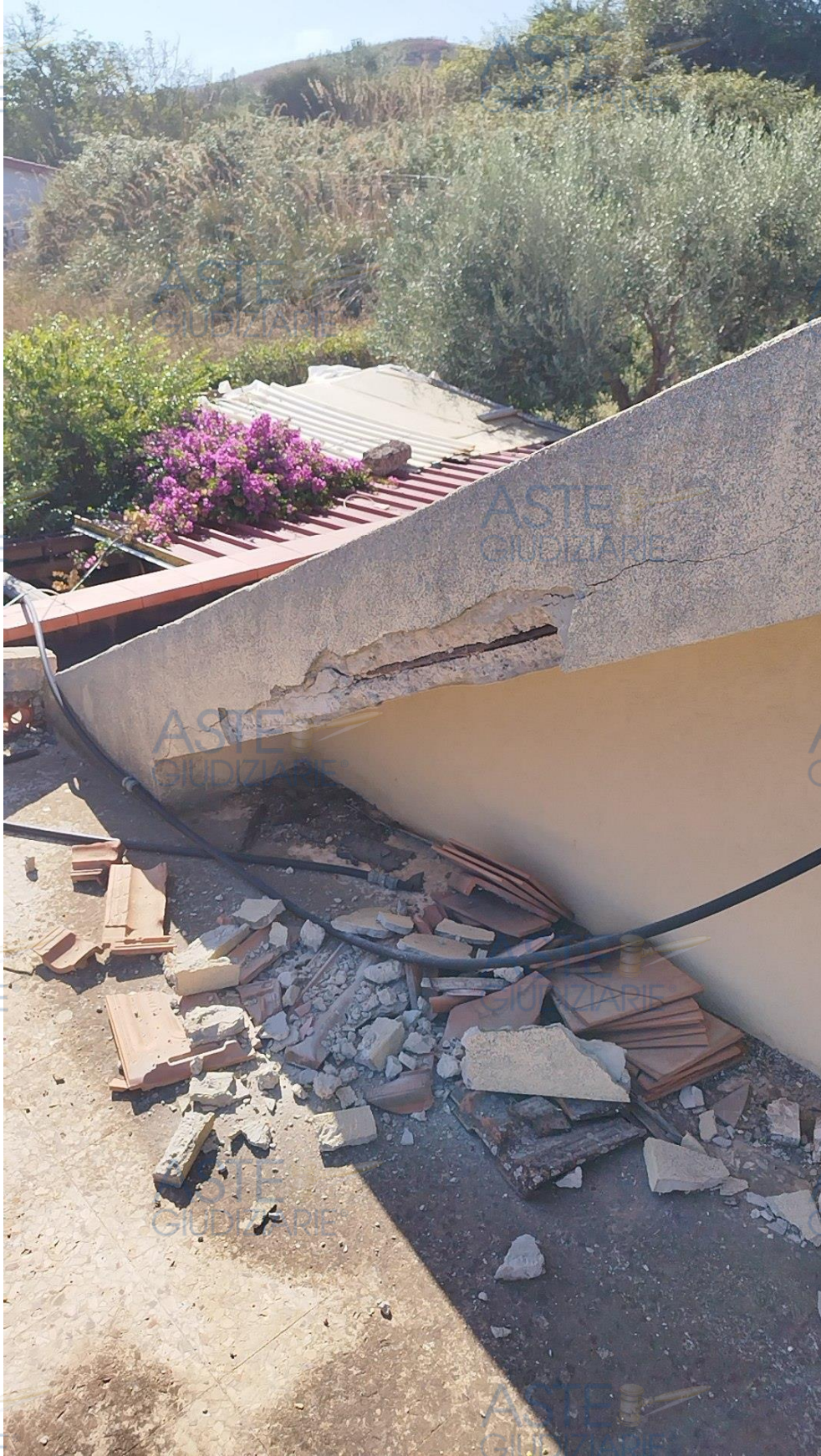
Foto 33: distacco cemento copriferro cornicione copertura
