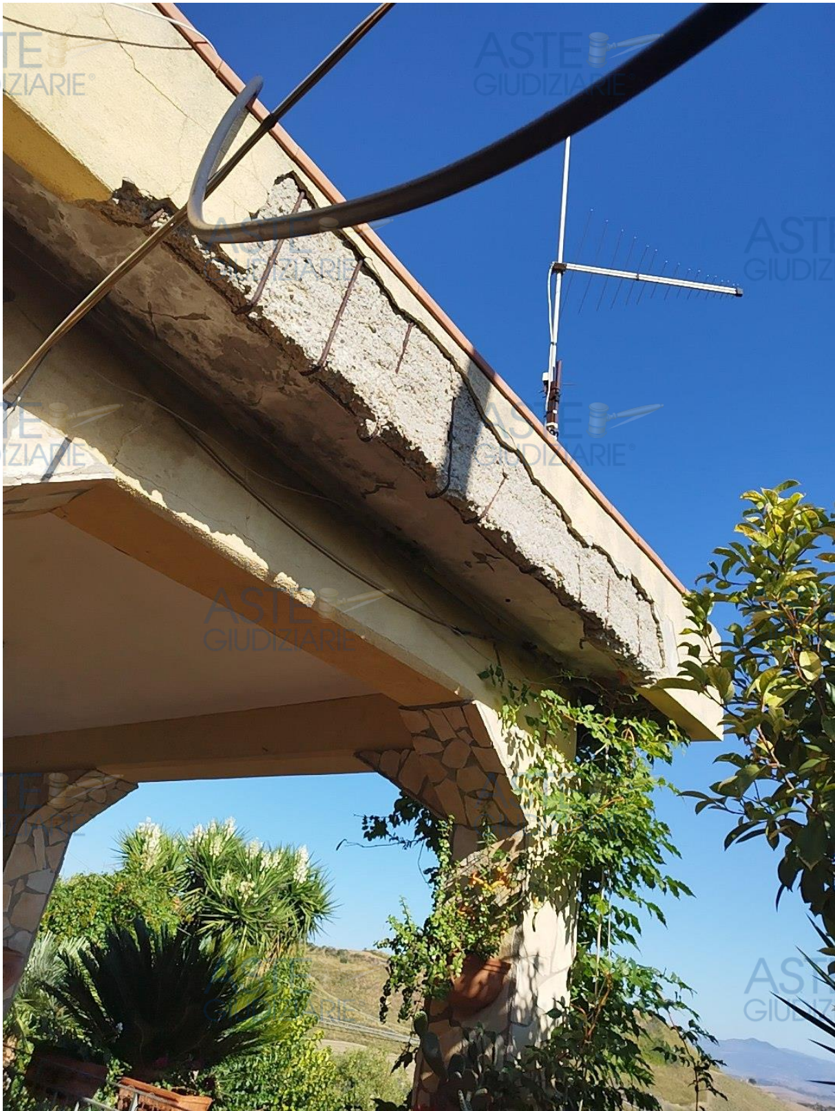
Foto 27: distacco cemento copriferro cornicione portico
