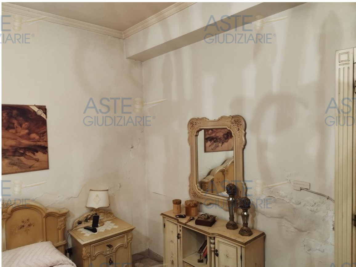
Foto 12: lesioni nei muri e umidità nelle pareti
