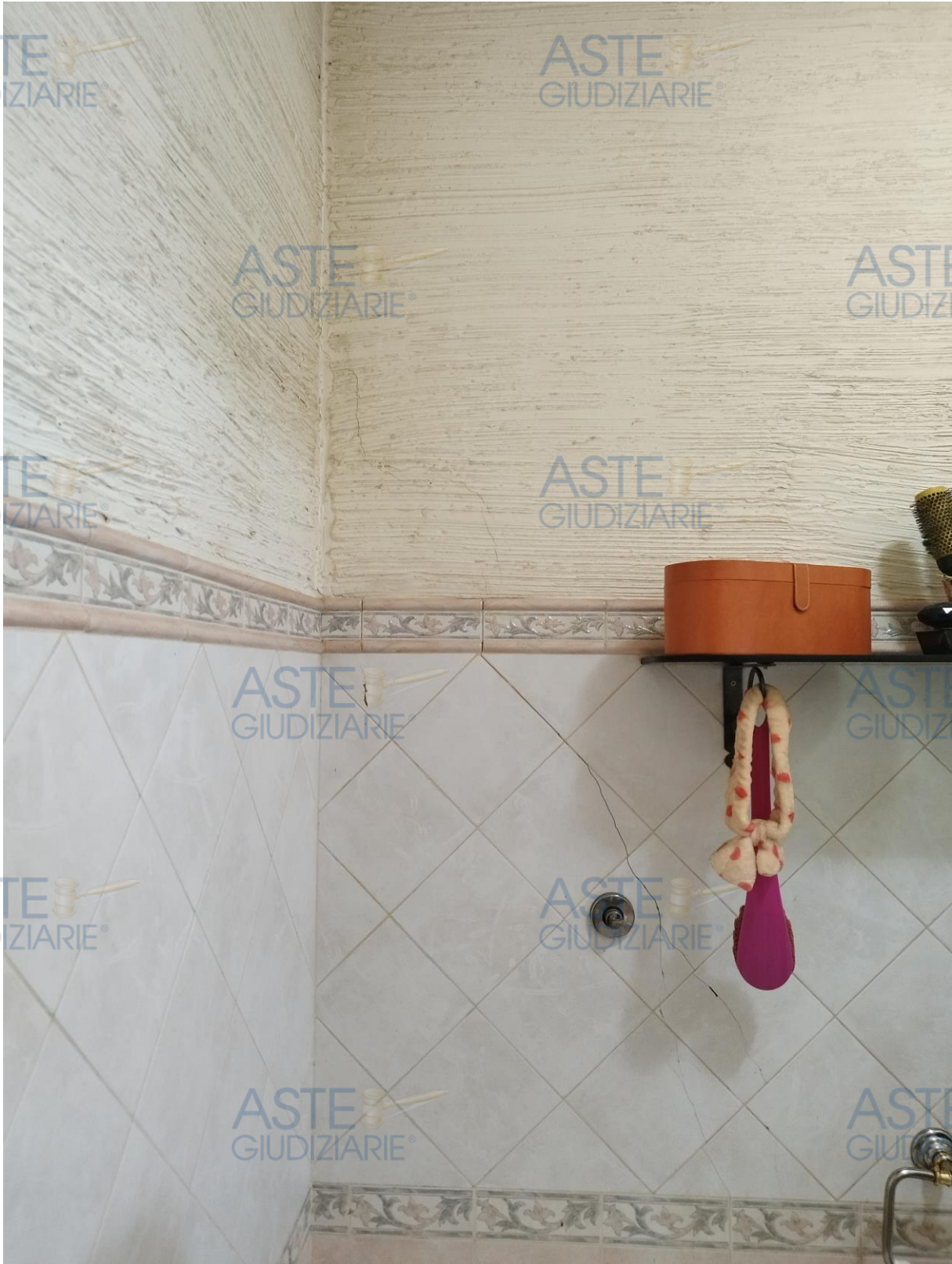
Foto 16: lesioni nei muri vano w.c.
