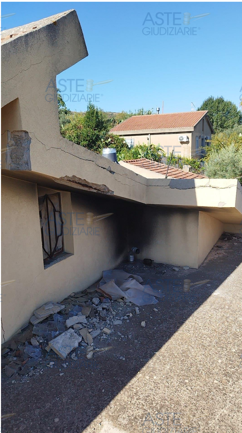
Foto 32: distacco cemento copriferro cornicione copertura
