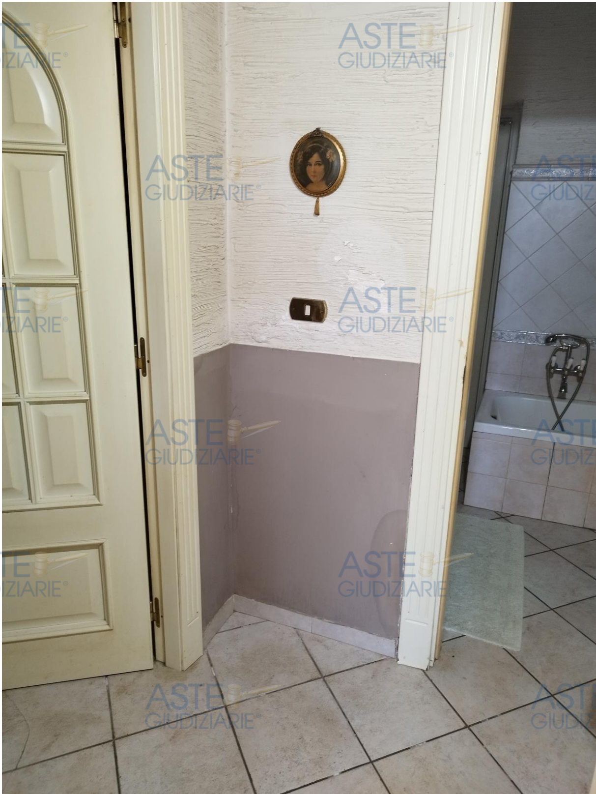
Foto 8: lesioni nella pavimentazione e umidità nelle pareti
