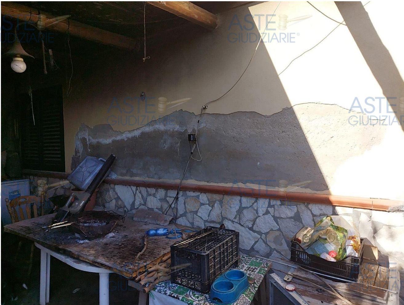
Foto 26: caduta intonaco facciate esterne
