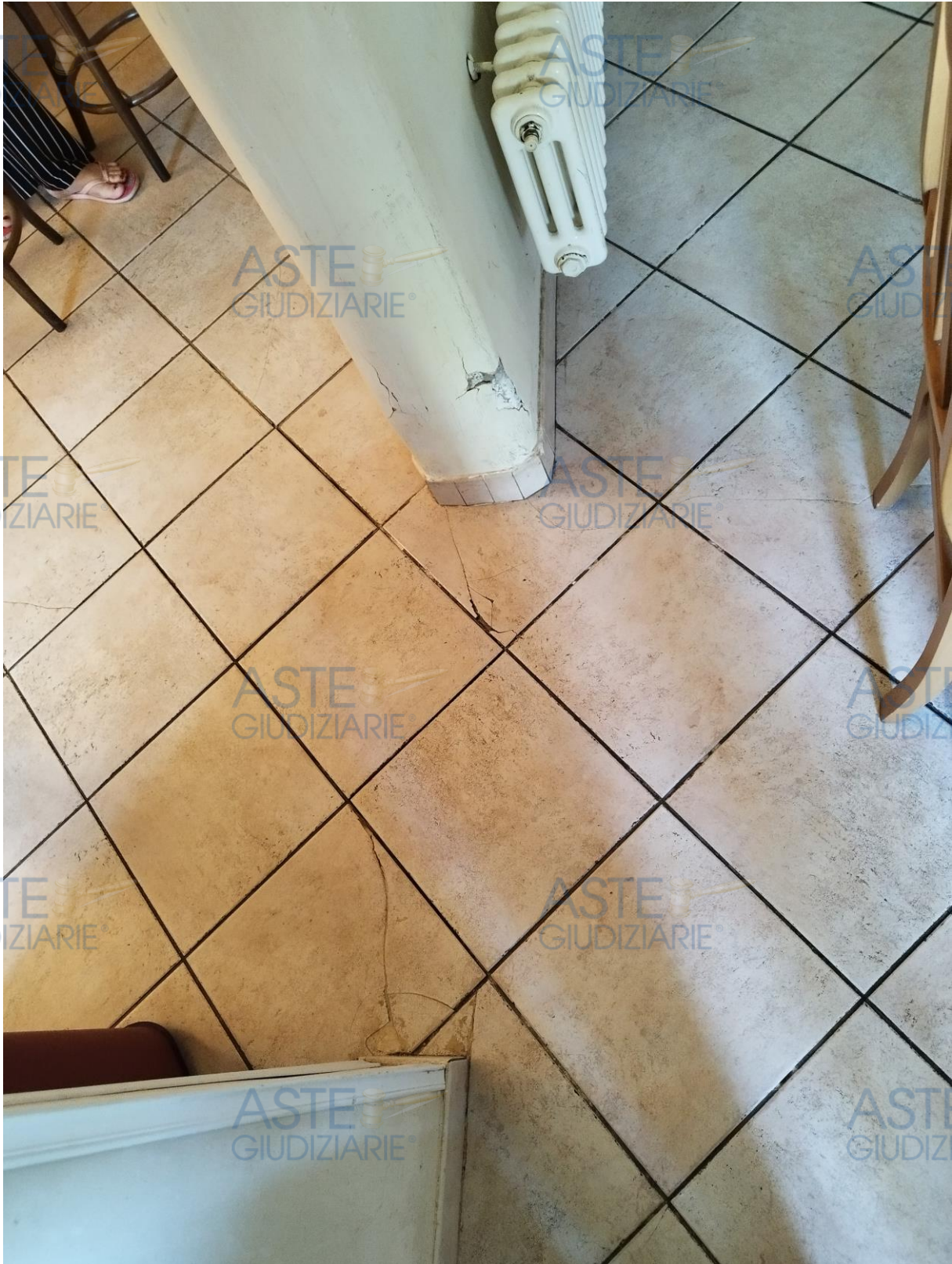
Foto 2: lesioni nella pavimentazione e umidità nelle pareti
