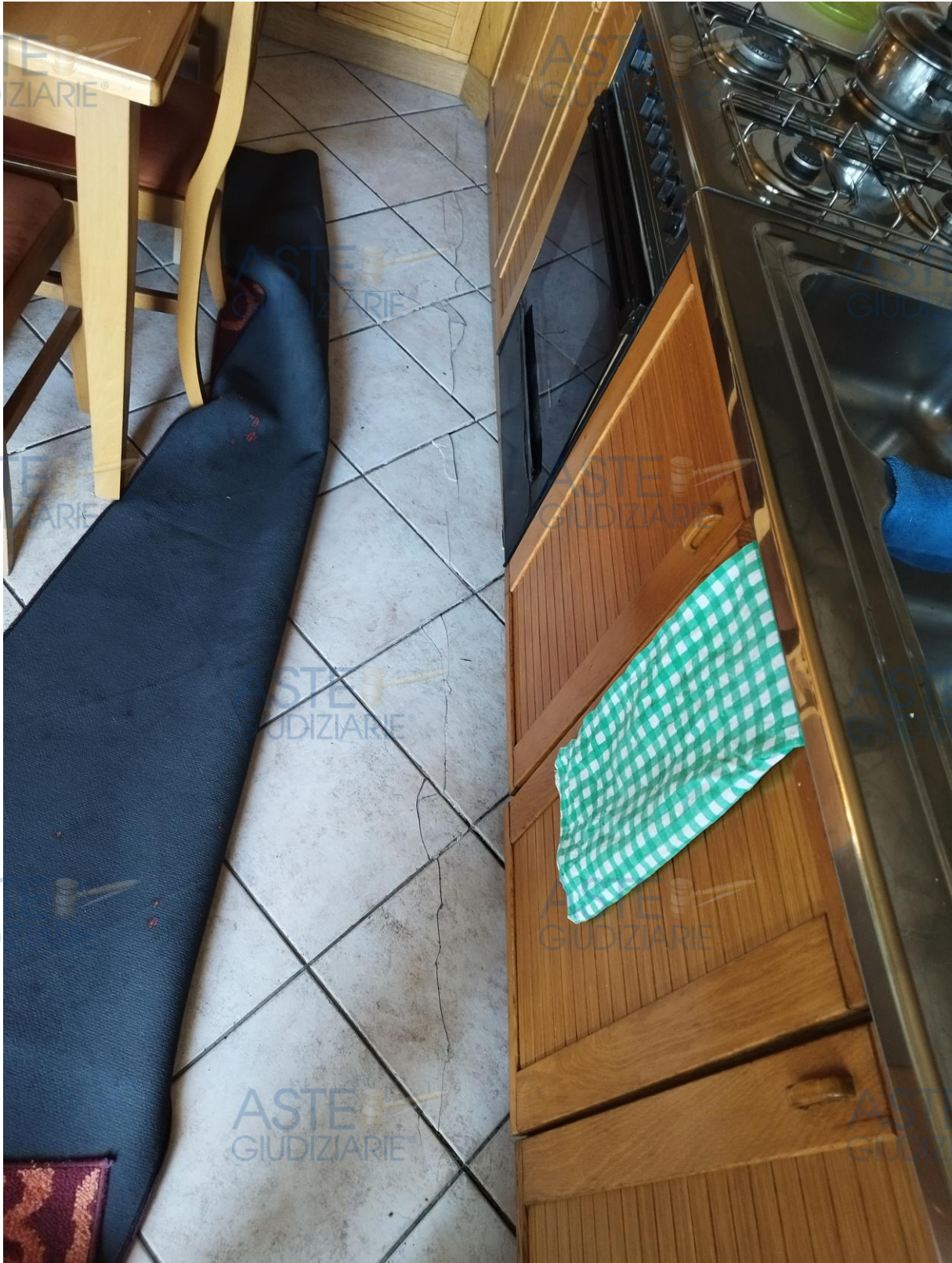
Foto 1: lesioni nella pavimentazione
