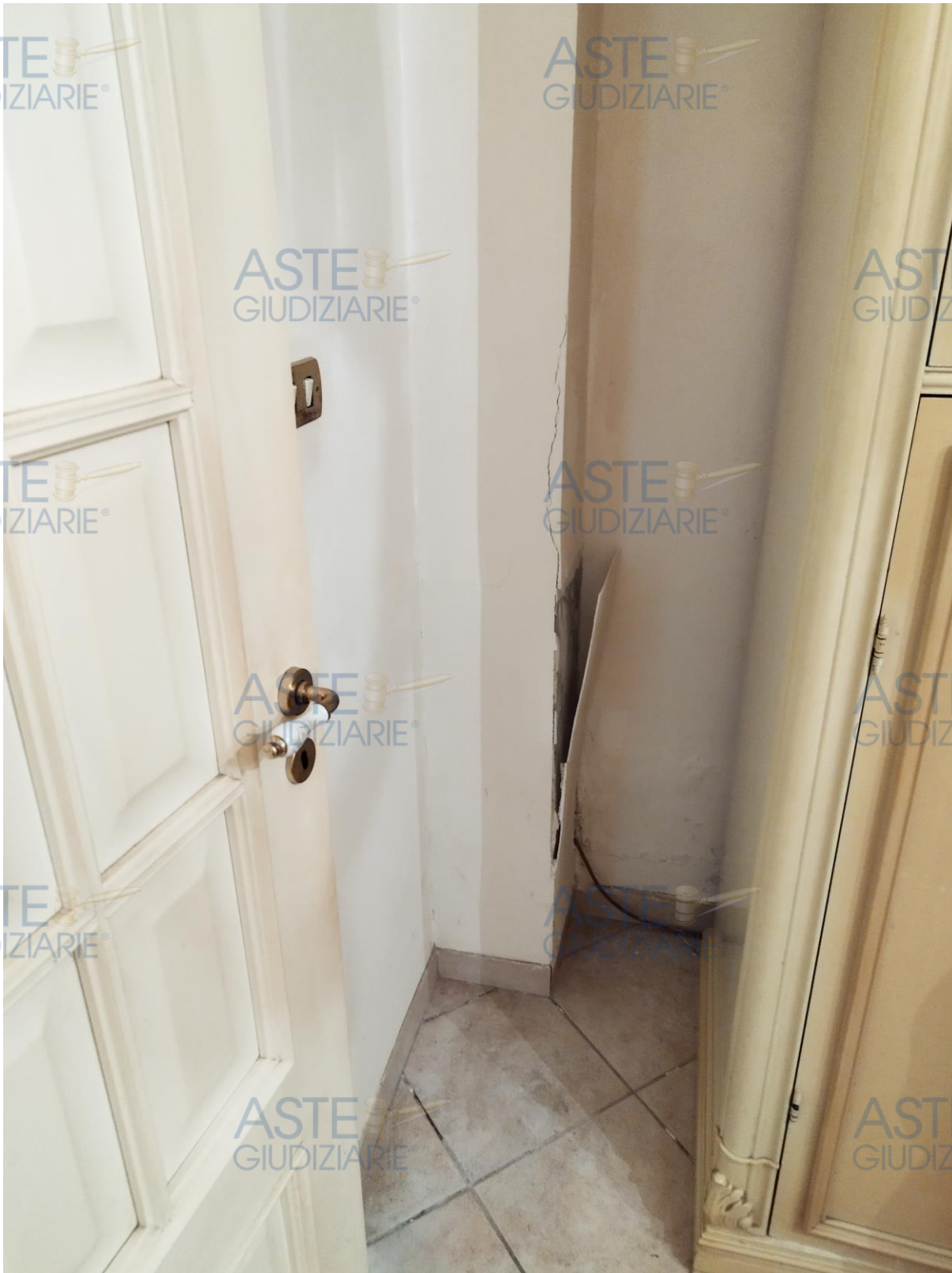
Foto 11: lesioni nei muri e umidità nelle pareti
