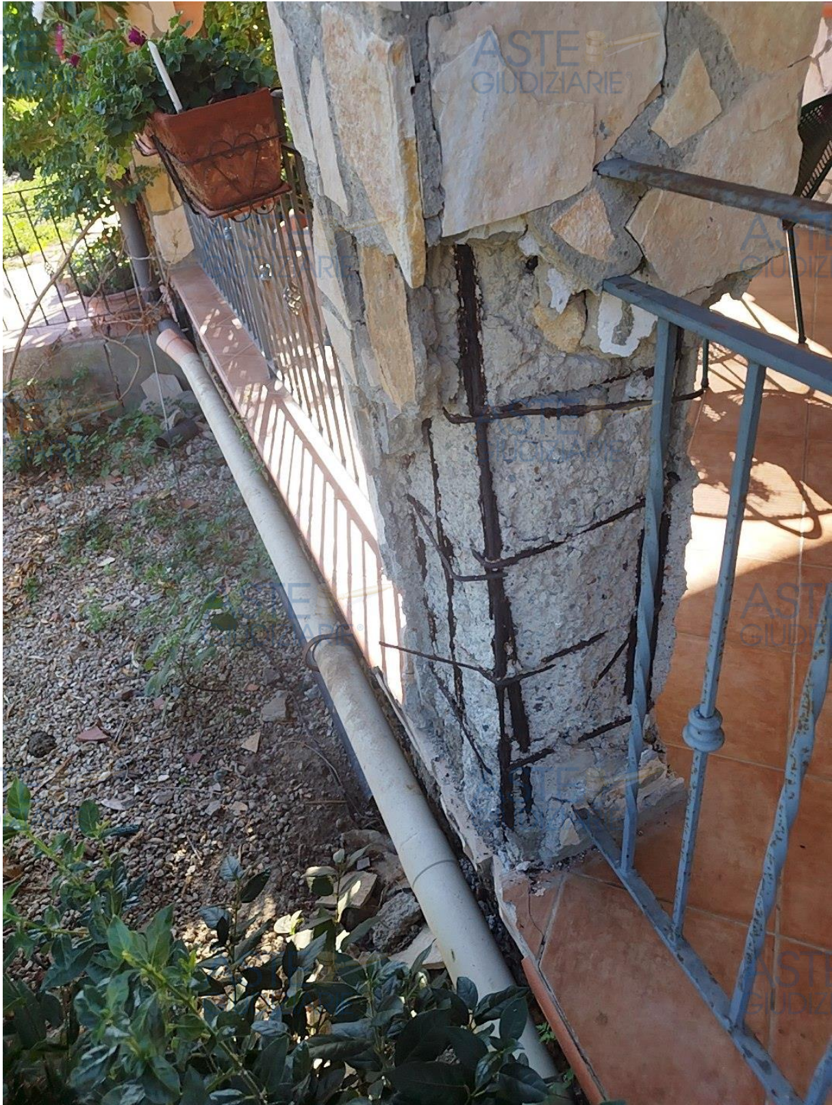
Foto 30: distacco cemento copriferro pilastro portico
