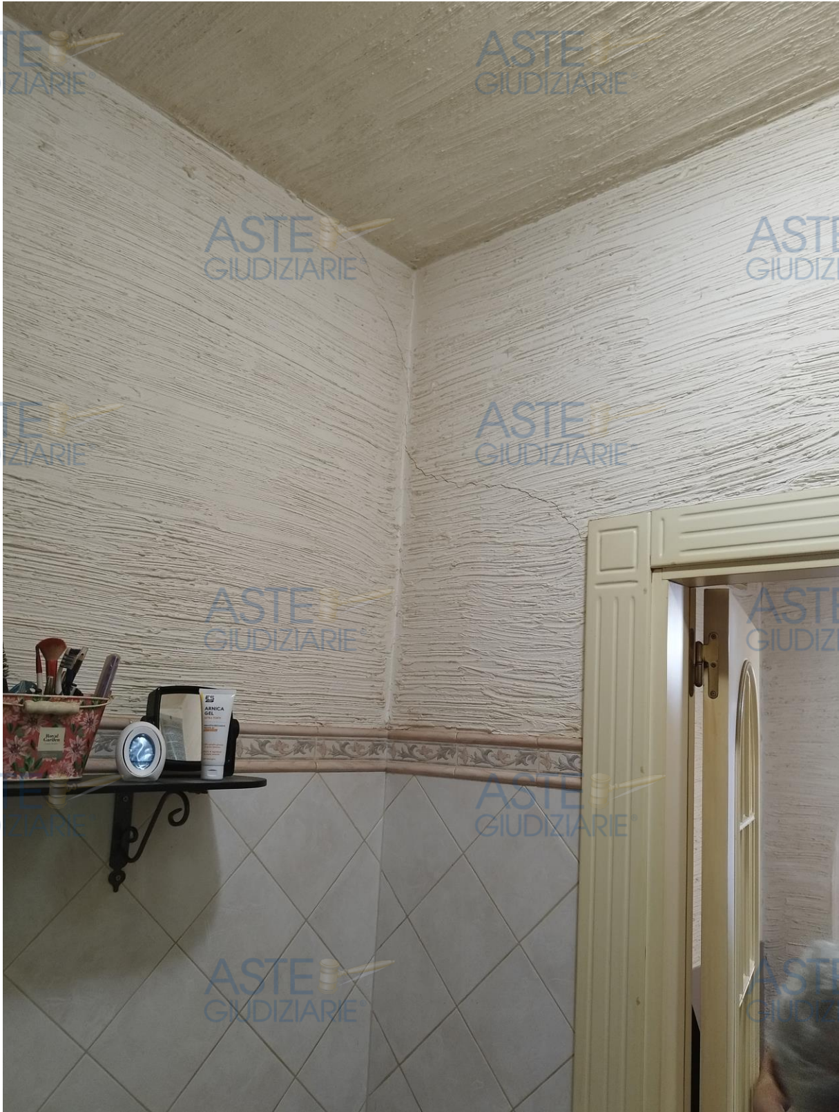
Foto 17: lesioni nei muri vano w.c.
