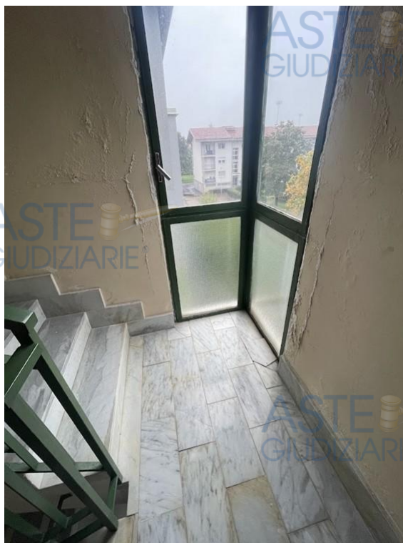
Fotografia A.11 - VISTE AMMALORAMENTI DELL'INTONACO VANO SCALA RILEVATI
