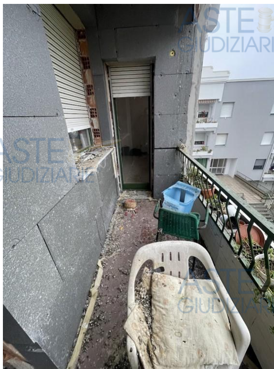
Fotografia A.23 - VISTE BALCONE LATO EST (NOTARE LA SPORCIZIA PRESENTE CAUSA ECCESSO DI ESCREMENTI PICCIONI)
