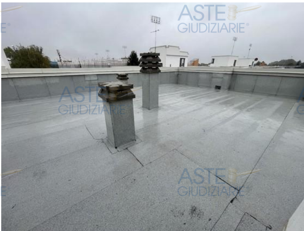
Fotografia A.35 - VISTE LASTRICO SOLARE DI COPERTURA (TERRAZZAMENTO)
