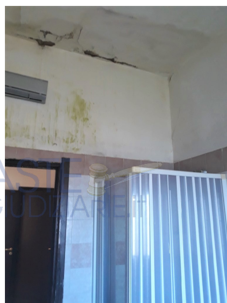
10. Villino originario. Le condizioni del soffitto e parete nell'angolo doccia.
