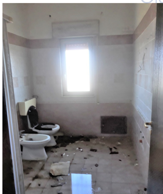
9. Villino originario. Le condizioni del bagno. Si nota il riflesso della finestra nel pavimento bagnato dalle vaste infiltrazioni dal soffitto sfondellato e le macerie.
