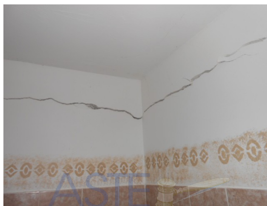
17. Ampliamento Nord, gravi fratture nelle pareti del vano WC
