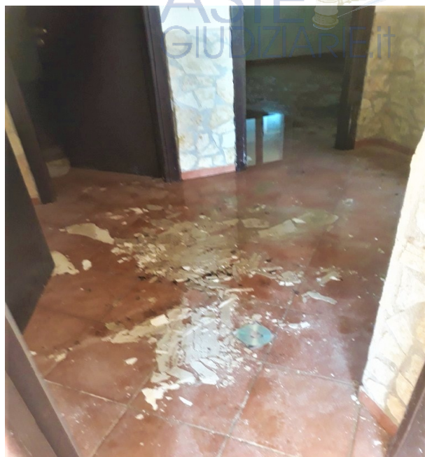
12. Villino originario. Il pavimento bagnato del disimpegno ricolmo di macerie di intonaci caduti dal soffitto per infiltrazioni
