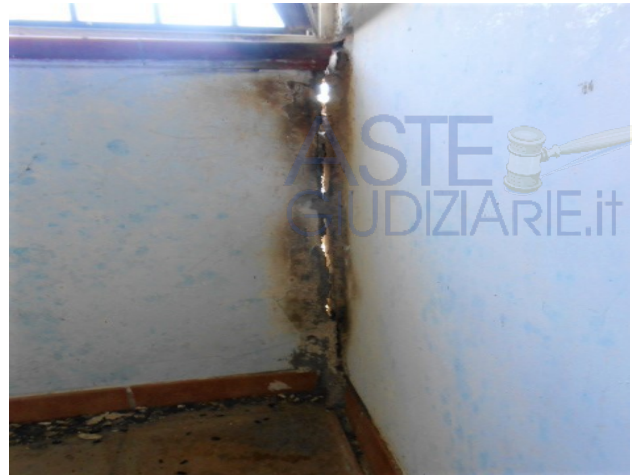
18. Ampliamento lato Nord-Est. Particolare del grave distacco verticale della muratura dal villino originario (a destra).
