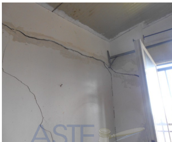
15. Ampliamento lato Nord-Est, gravi fratture macroscopiche diffuse
