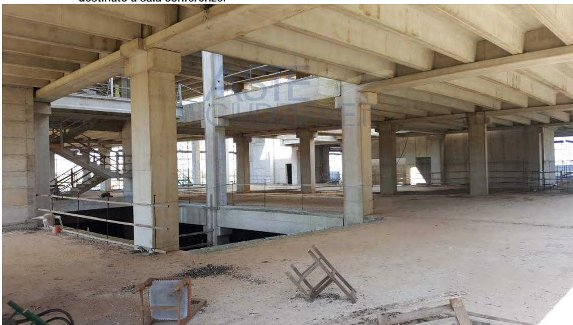
Foto n.3: Vista esemplificativa della organizzazione strutturale dell'edificio alberghiero, in corrispondenza dei piani in elevazione
