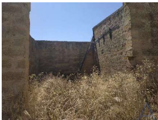
Figure 9 – Vista interna del vano non completato assimilabile ad un rudere
